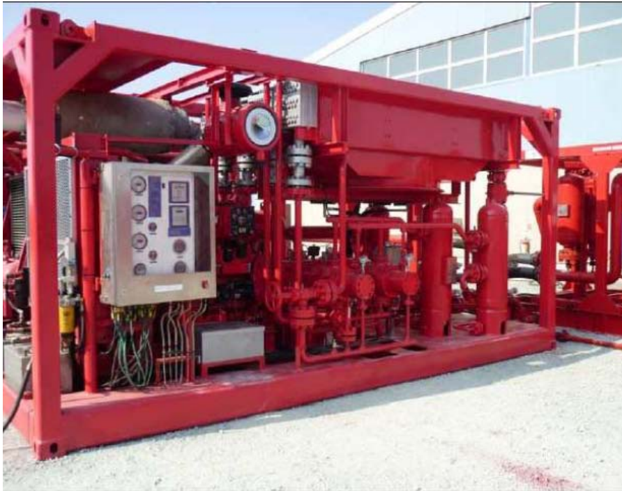
Figura 5-26: Esempio di compressore booster
