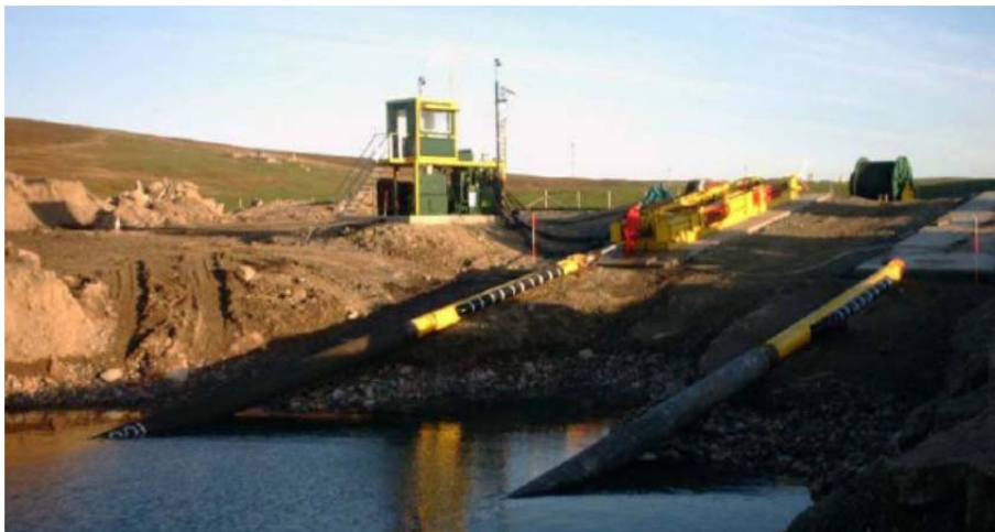
Figura 5-19: Foto di un esempio di collegamento all'argano su rampa inclinata
