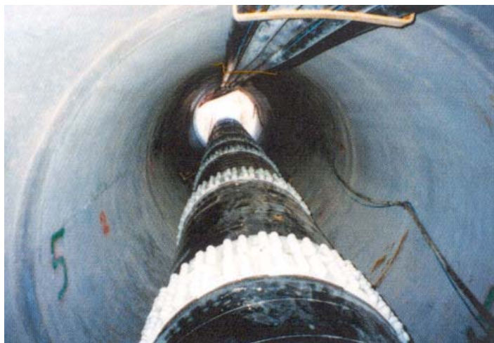
Figura 5-16: condotta posata nel tunnel. Sono chiaramente visibili i collari di plastica bianchi
