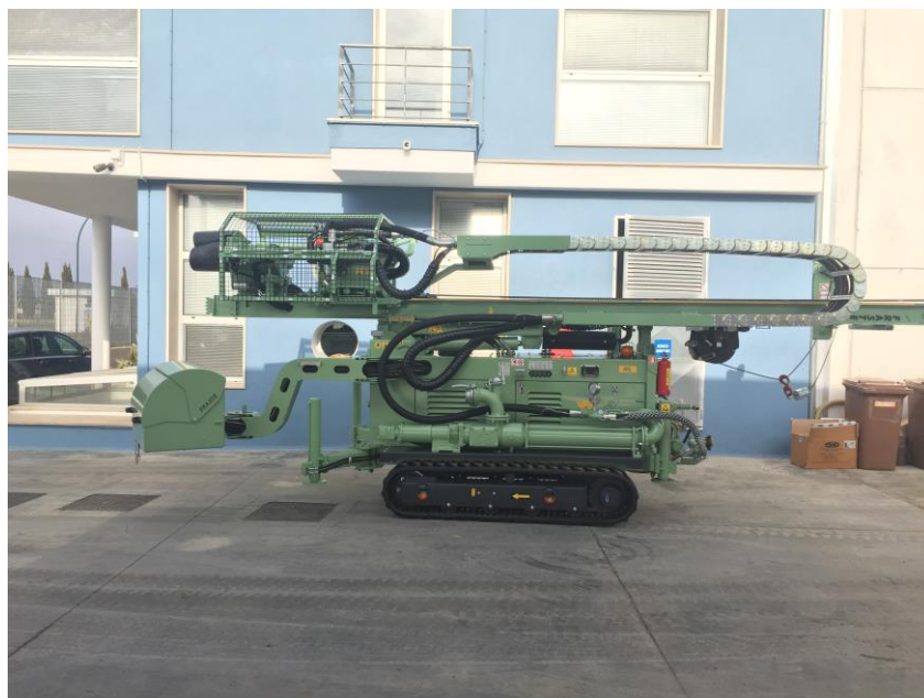
Figura 4.1 - Trivella tipo (sonda) per l'esecuzione del foro e successiva installazione del piezometro.
