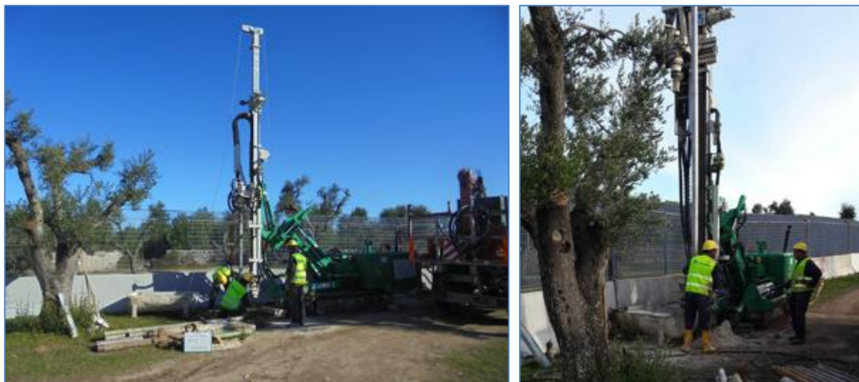
Figura 4.3 - Dettaglio installazione tipo di un Piezometro: trivellazione (a) e installazione piezometro (tubo).
