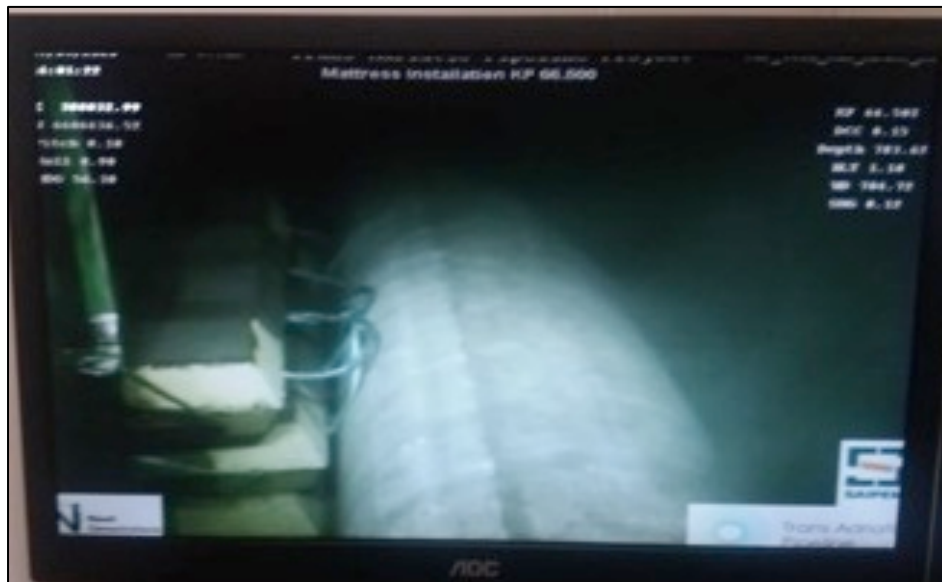
Figura 21. Monitoraggio alla posa del gasdotto in corrispondenza di uno dei punti con i materassi
