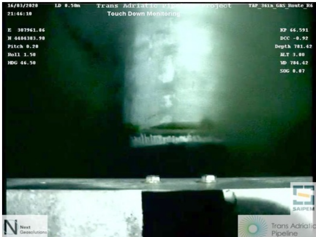
Figura 36. KP66.591, fase di posa della condotta all'esterno dell'area del CF 02/2018 (Cfr. Figura 25 – Foto_11)
