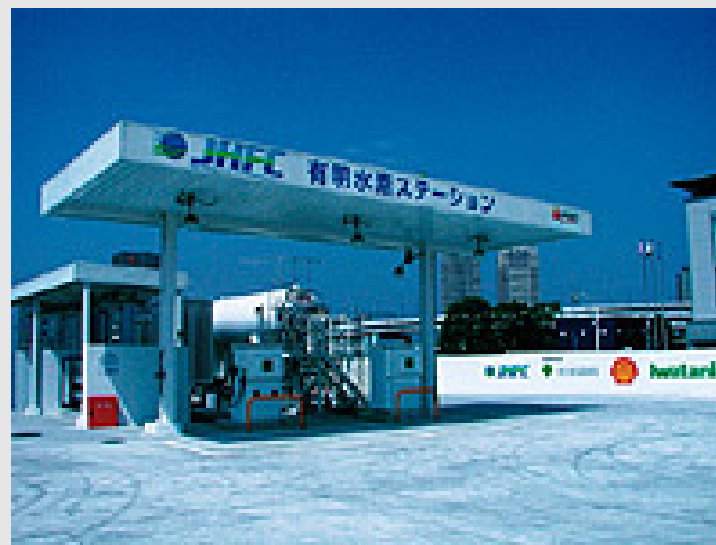
Stazione di distribuzione dell'Idrogeno - Yokohama
